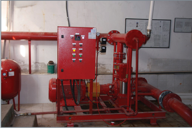
Yangın Pompa Grubu
